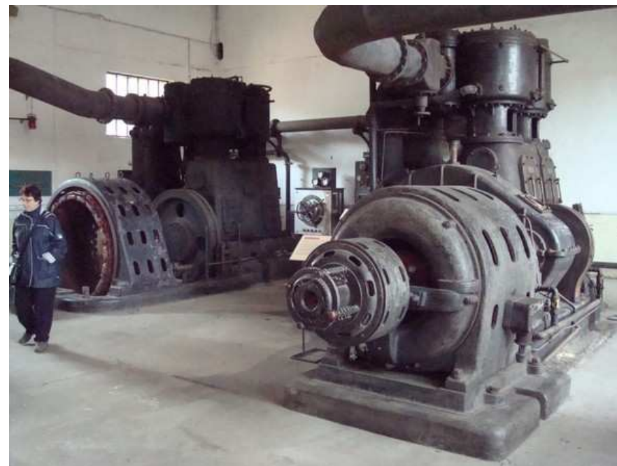
Un regard sur les machines de surface, ventilation
